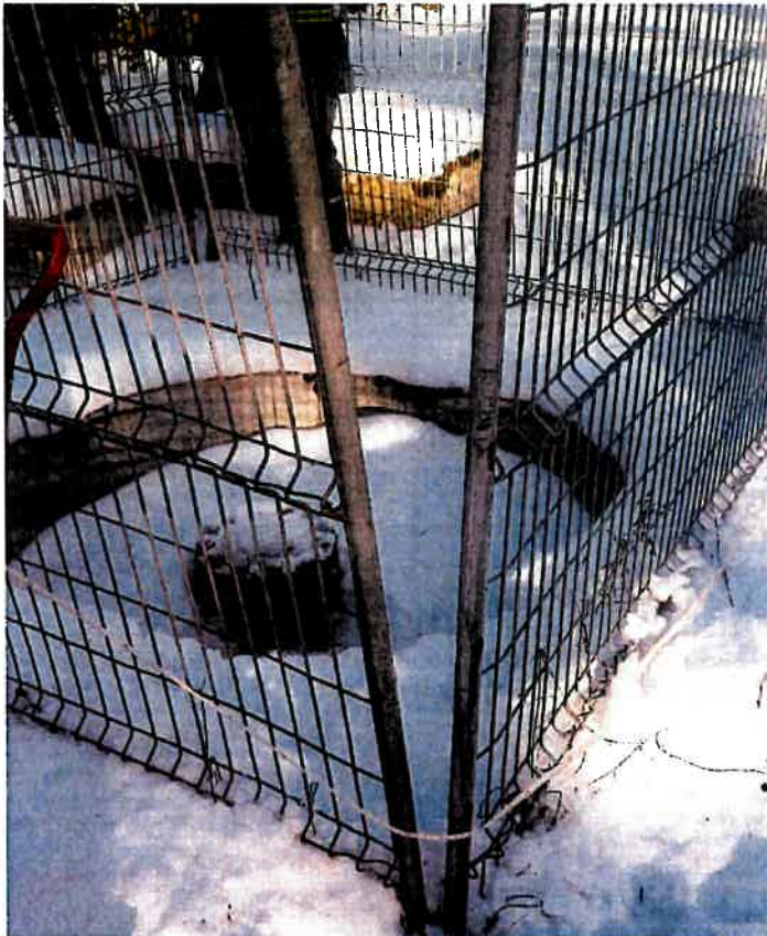
Photo 2 : Accès non-sécurisé du puits
