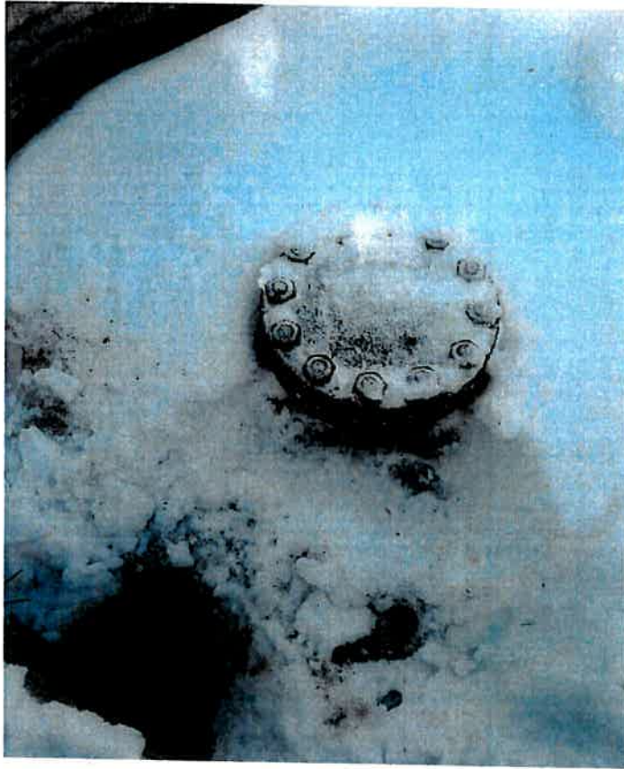
Photo 3 : Plaqué d'acier boulonnée et endroit du prélèvement d'eau
