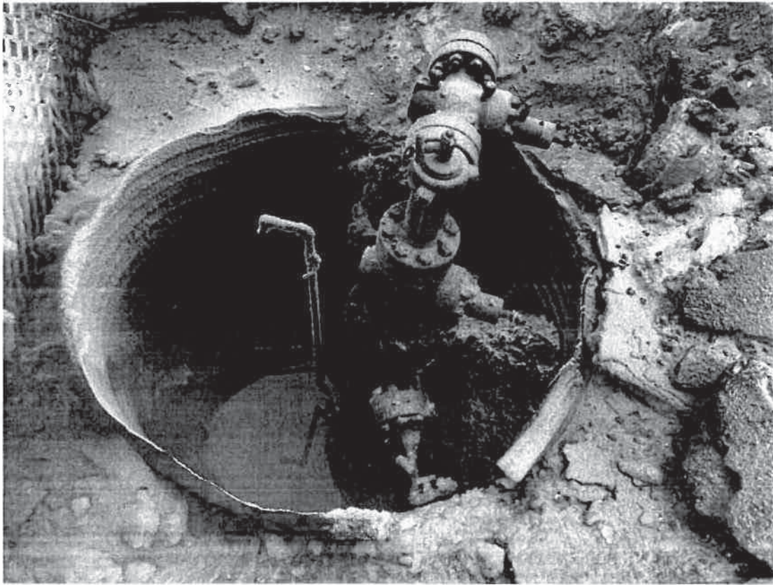
Figure 4 : Puits après l'incident (15 février 2020)
