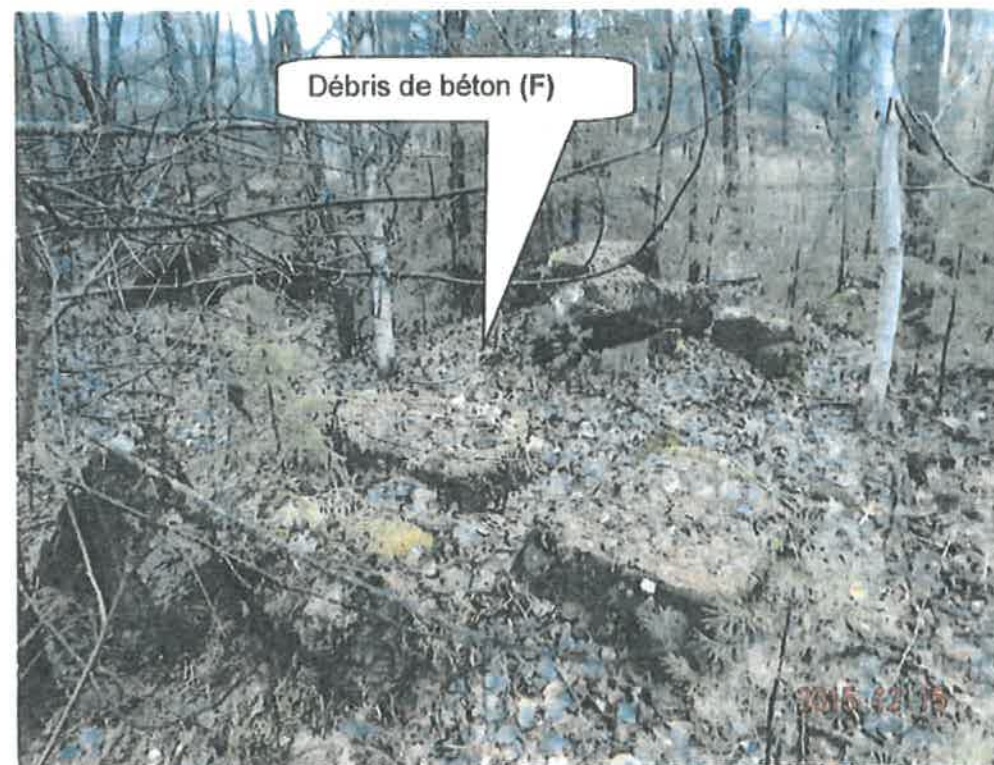
Mos-2015-12-15-005 – Débris de béton (F) (vue vers le Nord-Ouest)
