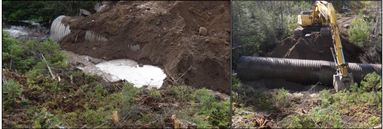
Figure 2. L'eau circule autour du ponceau une fois que le matériau en amont est enlevé (gauche). Le ponceau s'est détaché sous l'effet de l'écoulement dessous et au pourtour (droite).
