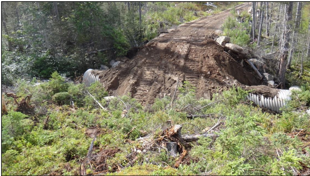
Figure 1. Côté stabilisé avec mousse et suffisamment de matériau pour permettre aux machines de traverser.
