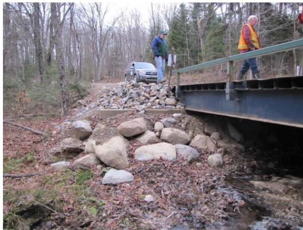
Figure A4 : Pont temporaire
